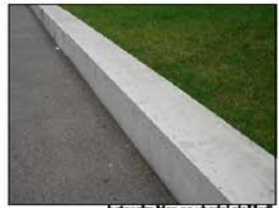
betonaka klopa na vhodni ploščadi
